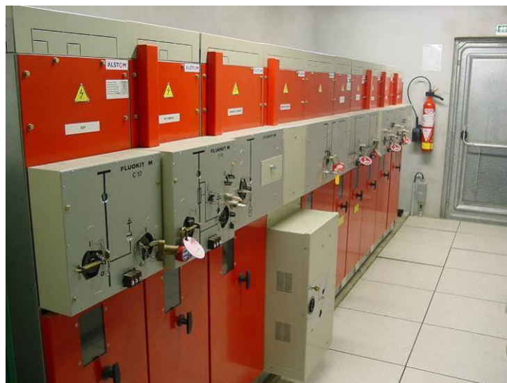
Intérieur d'un poste de livraison
